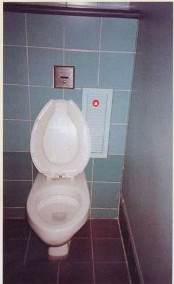
a. Intake Grilles
